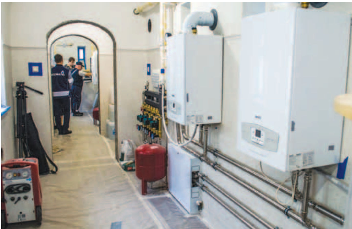
Новая котельная единоверческого храма Архангела Михаила.
